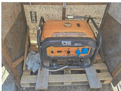
GENERATOR GT 15000E-A, 8 KW, NR. IN'
