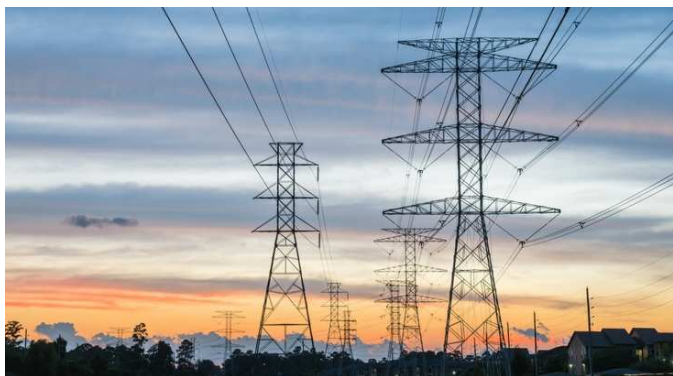
Transport energie electrică
